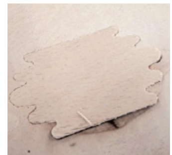
Defekt nach der Reparatur
